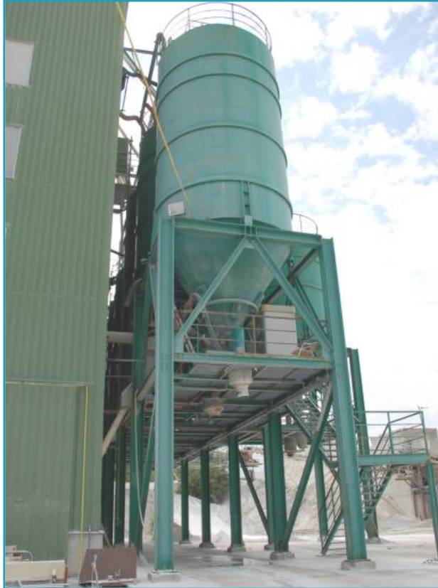
Silo mit Behälterfüßen
