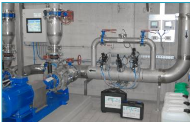
Prozess mit sSI - smart Sensor Inspect
